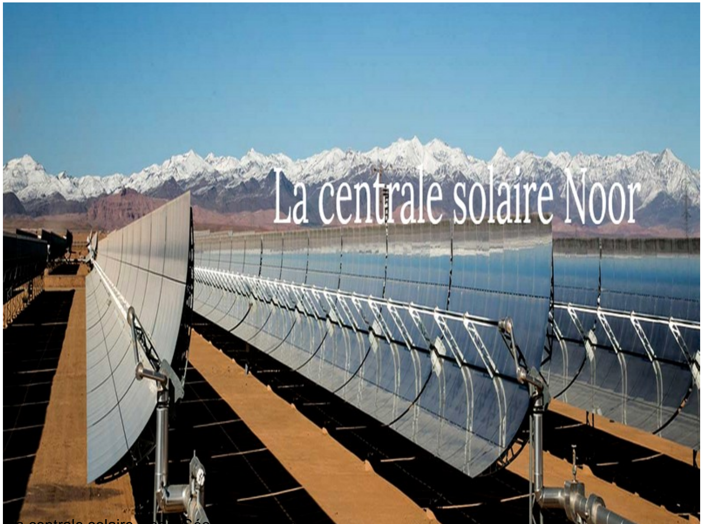
La centrale solaire Noor (Géoparc Jbel Bani)
