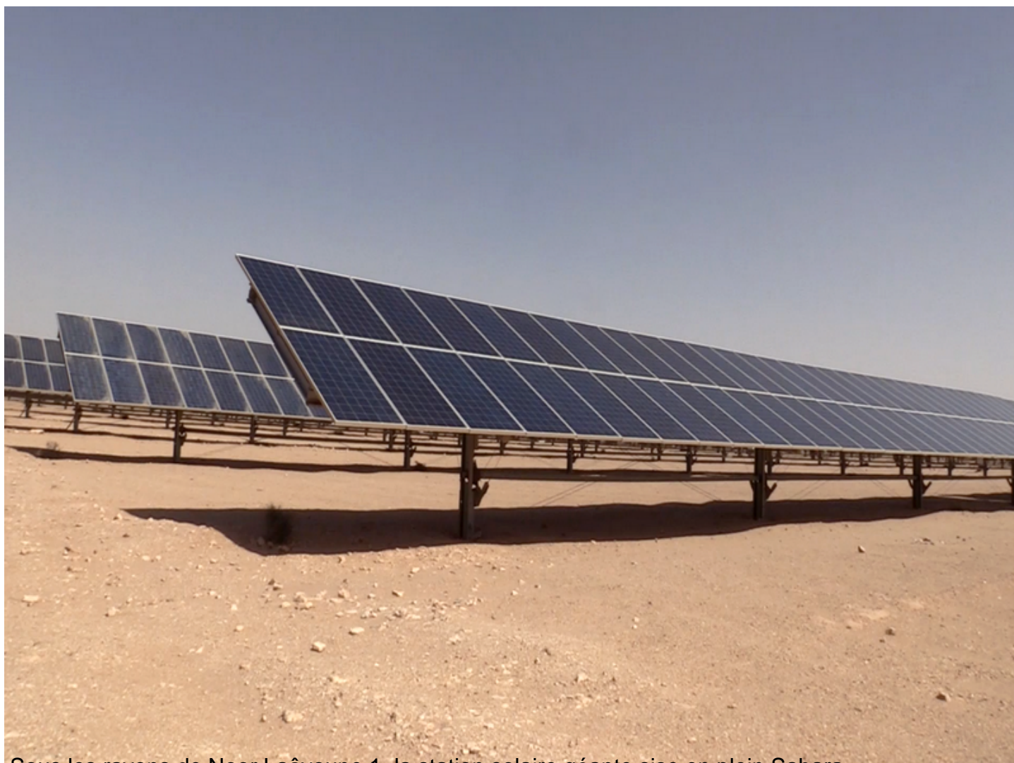
Sous les rayons de Noor Laâyoune 1, la station solaire géante sise en plein Sahara
