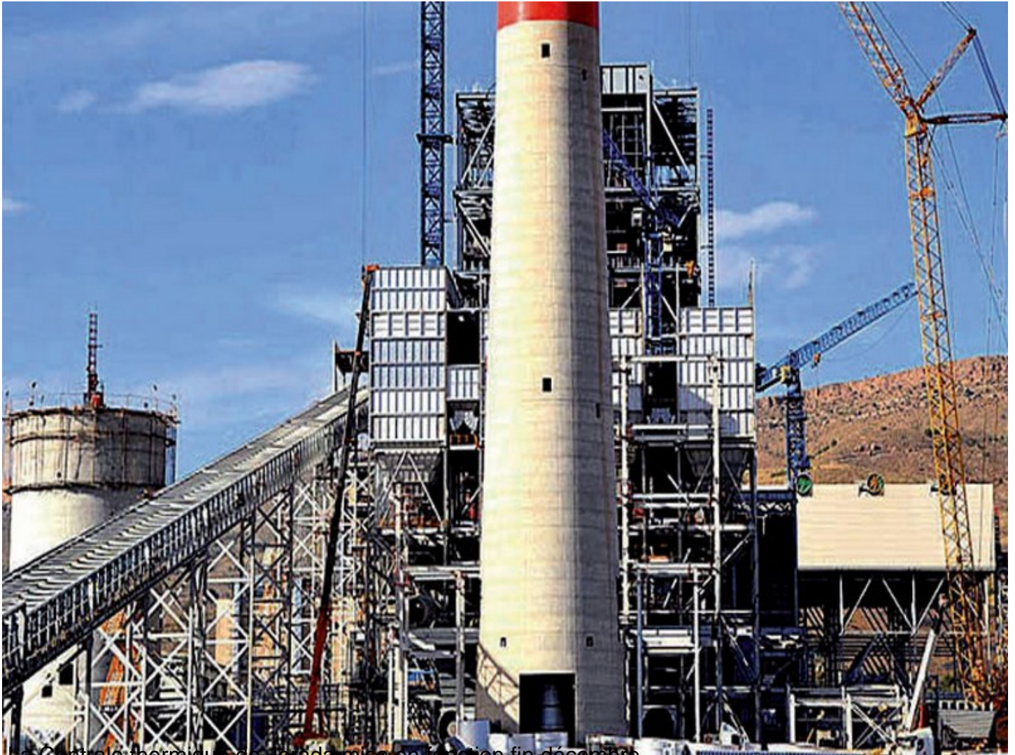
La Centrale thermique de Jerada mise en fonction fin décembre
