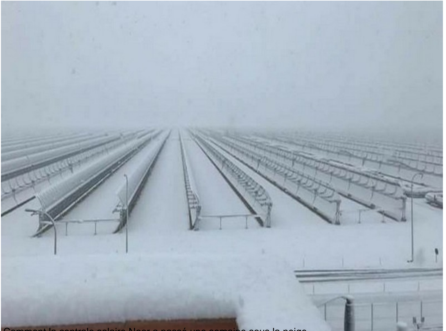
Comment la centrale solaire Noor a passé une semaine sous la neige
